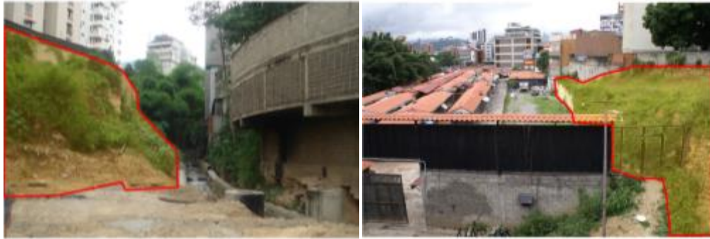
Imagen 5.10 Taludes sin mantenimiento. Fuente: Elaboración propia.
