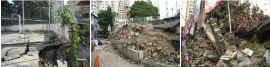
Imagen 5.11 Colapso de la Infraestructura construida. Fuente: Diagnóstico participativo Barrio Hoyo de Las Delicias
