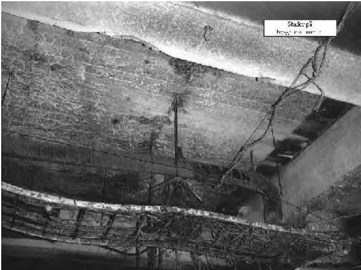
Bild 10 Skador på balkar och tak inne i klädavdelningen.
