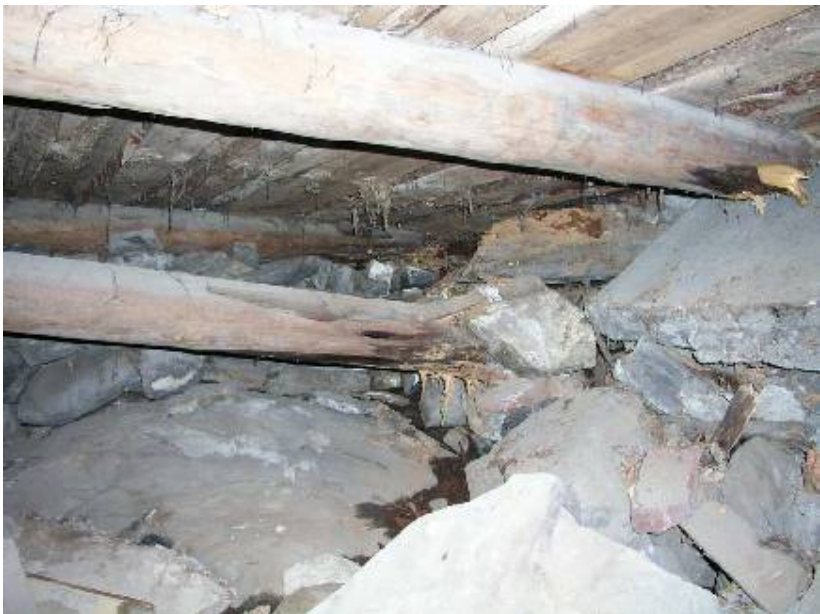
10_Hulikka_kellari_g.jpg Vasat lahonneet poikki, korjattava.
