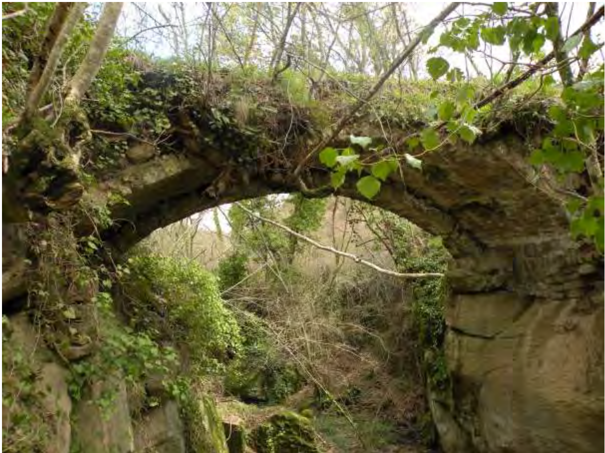
Fig. 2: I resti tardomedievali del cosiddetto Ponte Capello in loc. Macchia dell’Ospedale (veduta da Nord-Ovest)
