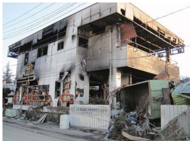
地震と同時に火災も発生しました
