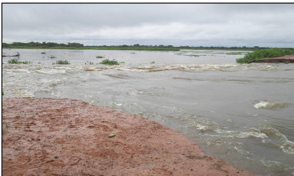
Figura 13 – Barragem da Trizidela mostrando a área de rompimento e o escoamento da água para o canal Maracu; abril de 2006.
