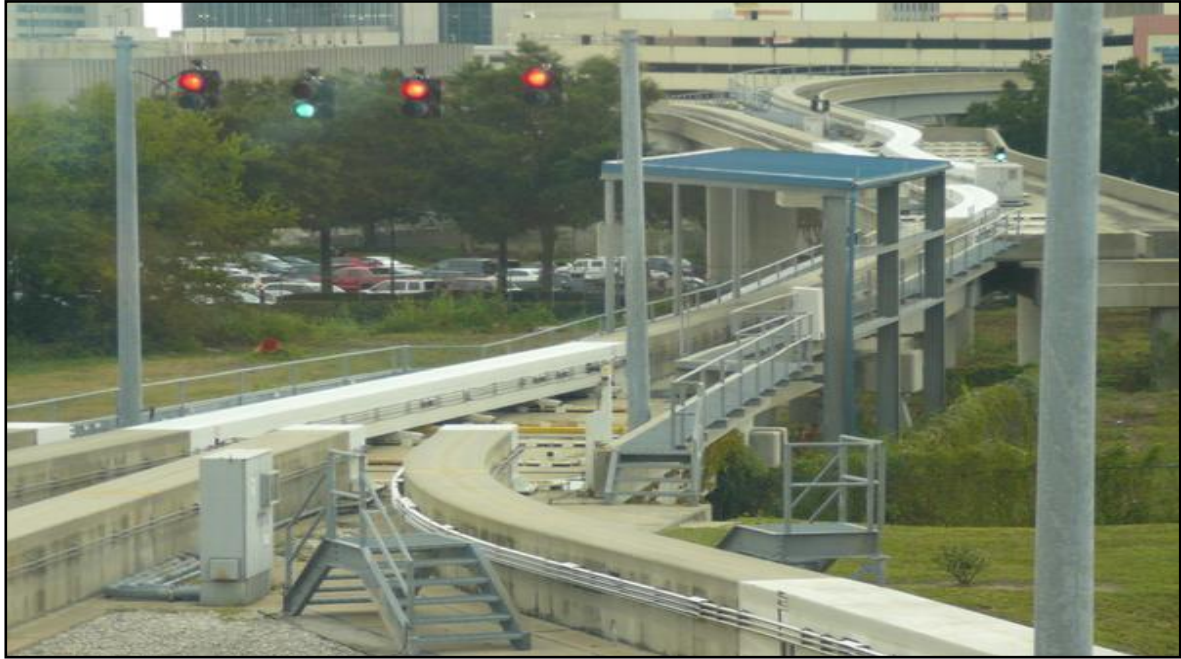
รูปที่ 3.9.3 - 14 ลักษณะโรงล้างรถไฟฟ้า (Train Washing Plant)
