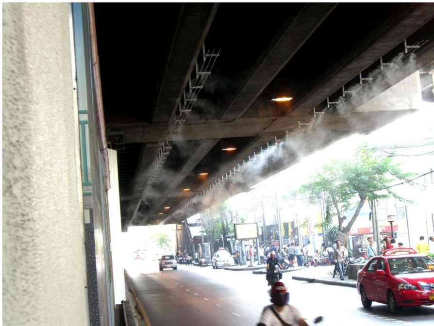
รูปที่ 7.1.5 - 1 ตัวอย่างระบบหัวฉีดละอองน้ำบริเวณใต้สถานีรถไฟฟ้า
