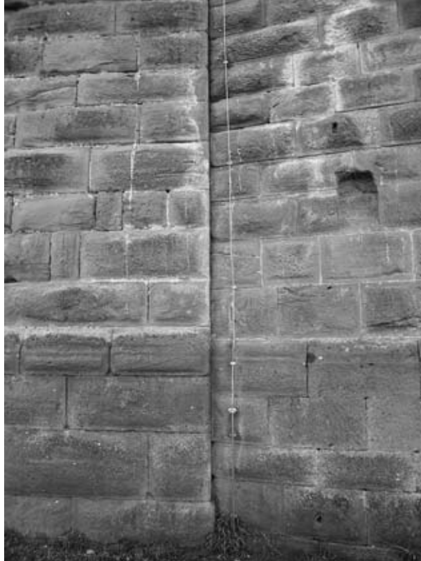
Abb. 24: Baufuge zwischen Kapellenturm (links) und Palas von Osten. Foto: R. Zimmermann.
