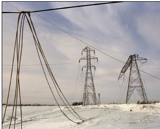
Kraftledningar kollapsade på grund av den kraftiga isbildningen (© Hydro-Québec)
