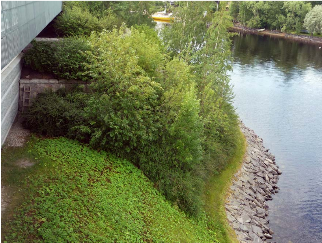
Kuva. Korkea siltapenger on tehty porrastettuna tukimuurina, jolloin istutuksilla on pystytty verhoilemaan maisemallisesti keskeisellä paikalla oleva luiska. Savonlinna.
