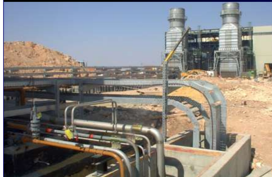
Centrale de F'kirina (2x165MW)
