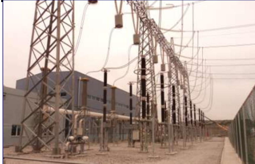
Poste Blindé de la centrale de Terga
