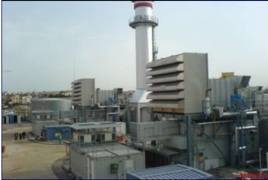
Centrale 2XGT 6B/6A6 de Bir el djir
