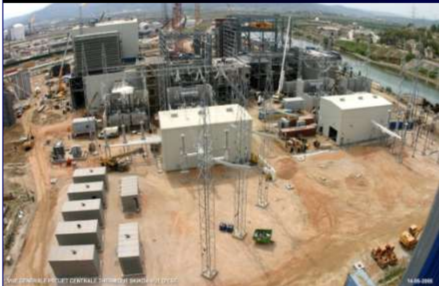
Centrale 800MW CC de Skikda
