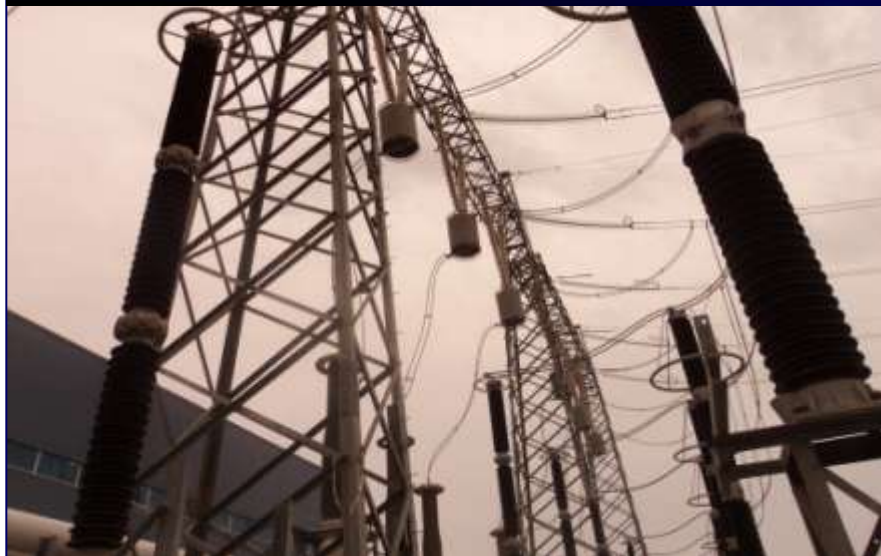
Poste Blindé de la Centrale de Terga
