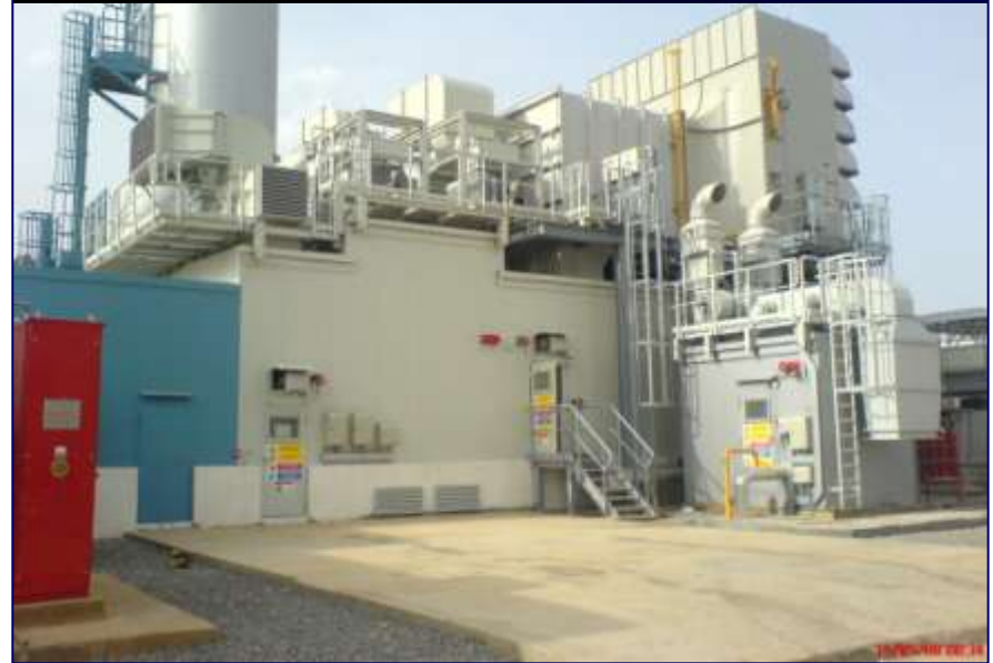
Centrale 2XGT 6B/6A6 de Bir el djir
