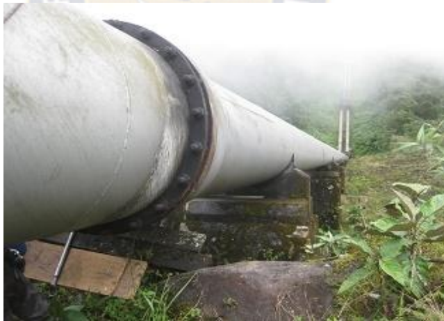
Fig.58 - Muestra la Ancla No.8 Sin Anormalidades.
