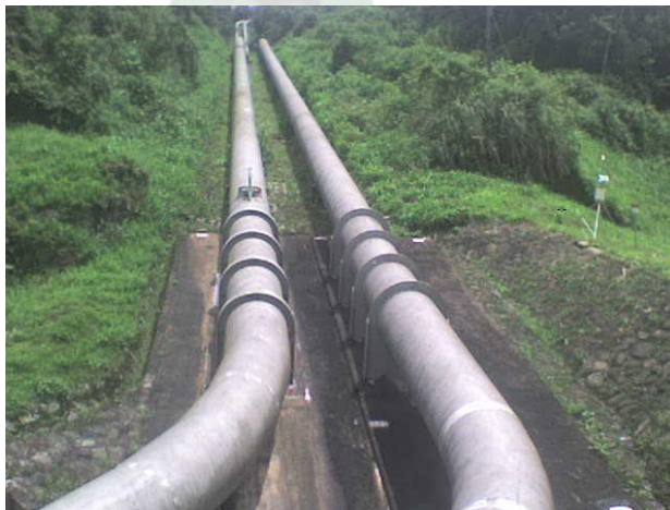
Fig.3 Tubería de Alta Presión Penstock.
