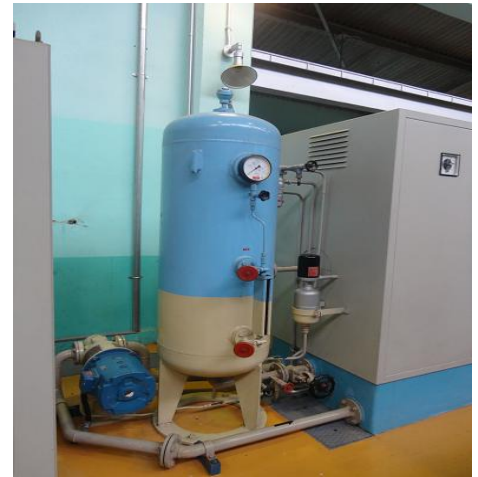
Fig.13- Tanque de Aire y Aceite.
