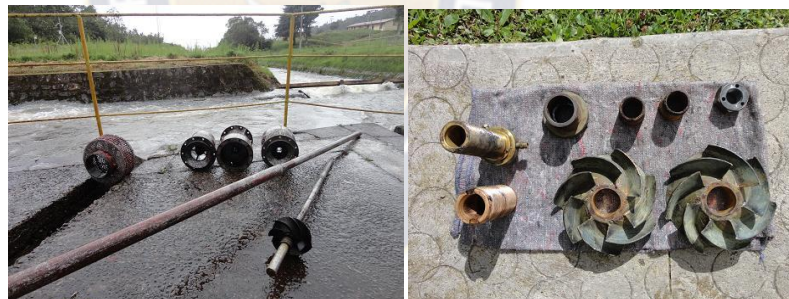
Fig.46- Piezas de la Bomba Desmontada.
