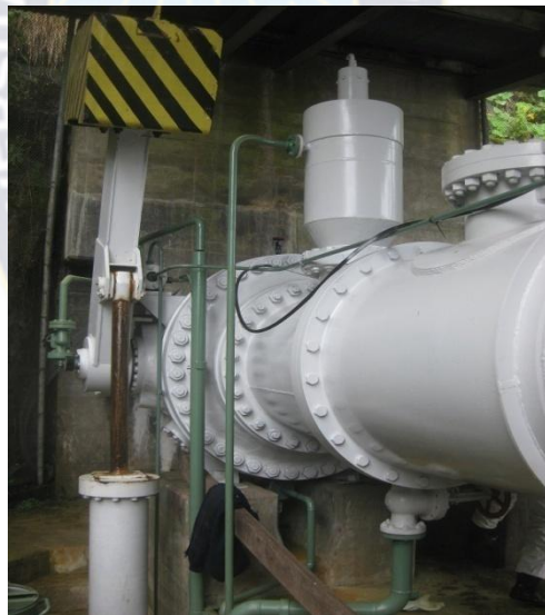
Fig.56 - Tubería de Alta Presión y la Válvula Esférica con su Contrapeso.
