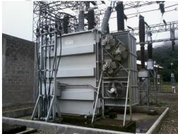
Fig.21- Transformador de Potencia Unidad - 3
