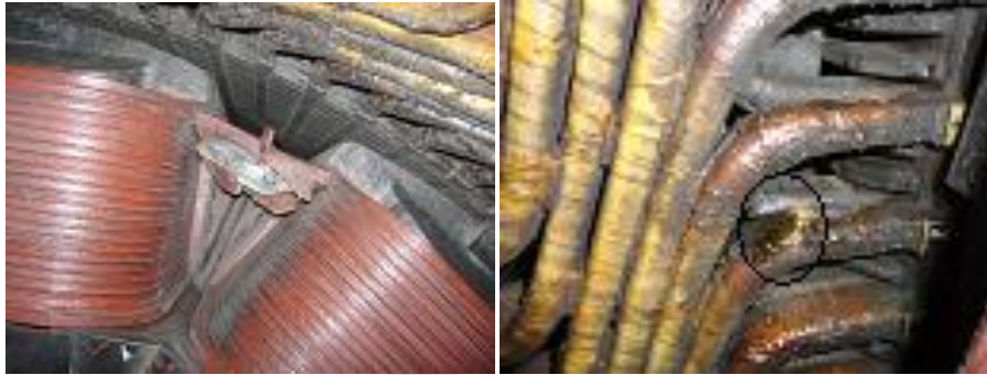
Fig.26 - Estado de Bobinas Antes de la Limpieza.
