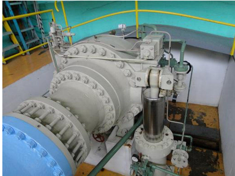
Fig.5 – Válvula Esférica de 600MM.
