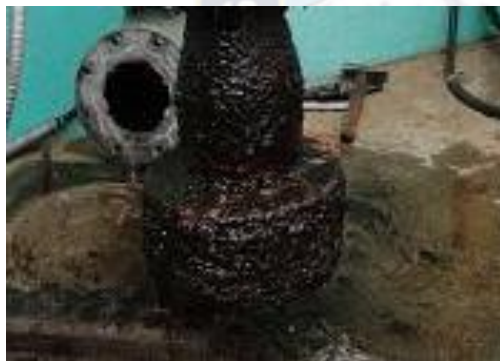
Fig.43- Filtro de Bomba Sucio
