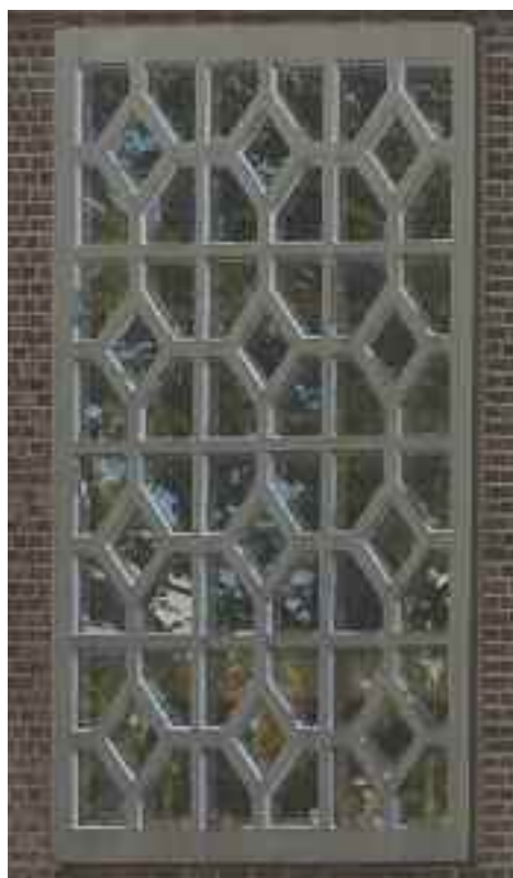
Fig. 46 Raamtraceringen van schokbeton in de Hervormde kerk in Zuidzande (J.H. Groenewegen, 1952).
