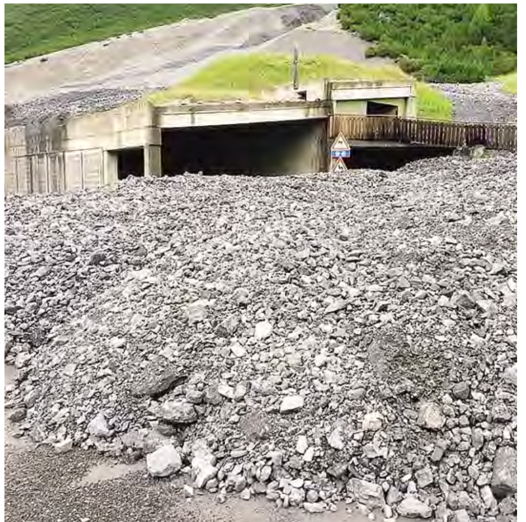
I ripetuti franamenti sul tunnel del Gallo ne hanno compromesso la stabilità
