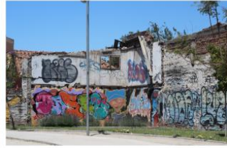
(10) Casa expropiada en Población Balmaceda para la construcción del paso bajo nivel San José.
