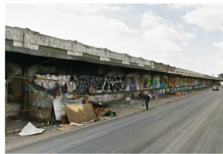
(5) Sector de descarga de FFCC Fepasa, zócalo que funciona como habitat para indigentes.
