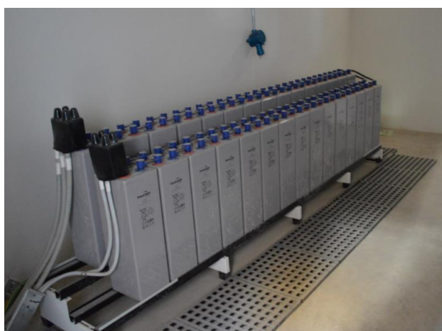
Banco de baterías
