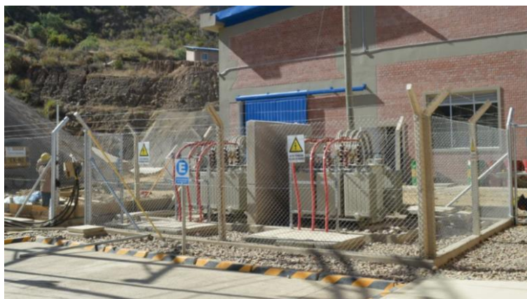
Transformadores auxiliares locales
