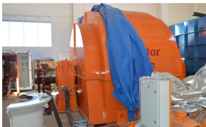
Vista sala de máquinas
