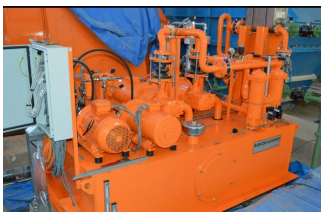
Vista gobernador hidráulico
