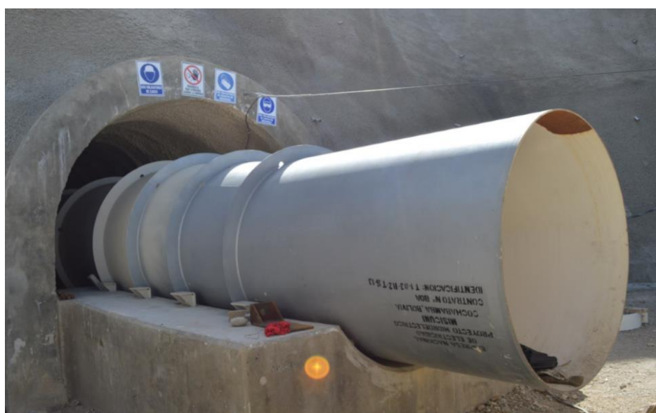
Salida de la tubería de presión Subterránea-Superficial
