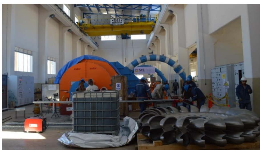
Interior de sala de máquinas Rodete, Generador
