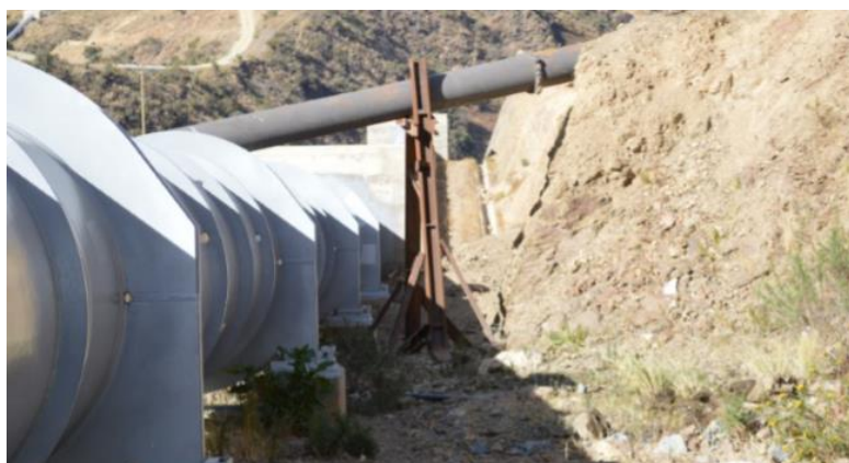
Vista conducción de drenajes artificiales
