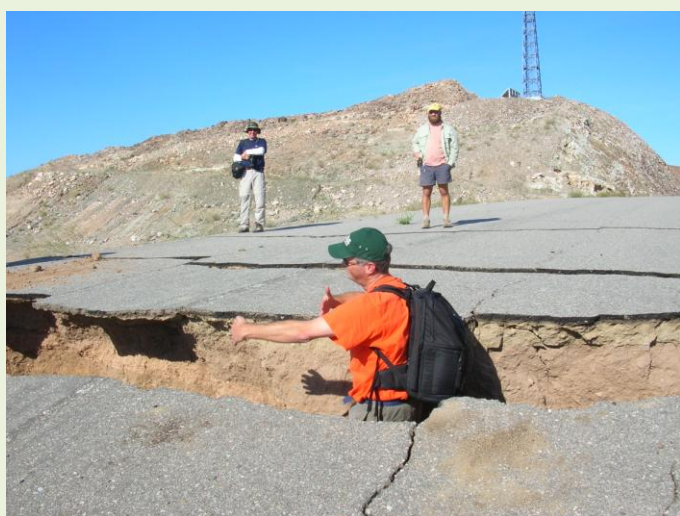
Figura 15. Grieta producida por el sismo. Se aprecia en su interior al Dr Kenneth Hudnut (USGS), mostrando la profundidad de la grieta y cómo se separaron los dos bloques por movimiento de la falla. Fotografía núm. 5765 de la autora, tomada el 27 de abril de 2010 al este de Laguna Salada y al norte de la carretera Tijuana-Mexicali. En el plano posterior figuran Sinan Acsiz (Universidad de California, Irvine) y Steven Skinner (Caltech).
