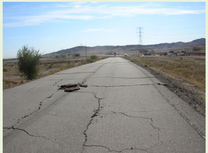
Figura 6. Grietas en un tramo viejo de la carretera Tijuana-Mexicali. Los camiones que se aprecian al fondo están en la nueva carretera 2 que ya fue reparada. Se nota que hay desplazamiento lateral sobre unas grietas con movimiento dextral (ver desplazamiento del borde del pavimento). Dirección de la vista: hacia el SE. Foto núm. 5767 de la autora, 27 de abril de 2010.
