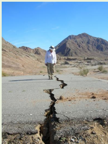
Figura 14. Tramo viejo de la carretera Tijuana-Mexicali con grietas producidas por el movimiento sísmico sobre una de las fallas que se desplazó el 4 de abril de 2010. Se aprecia una grieta en primer plano. Foto núm. 5768 de la autora, 27 de abril del 2010.
