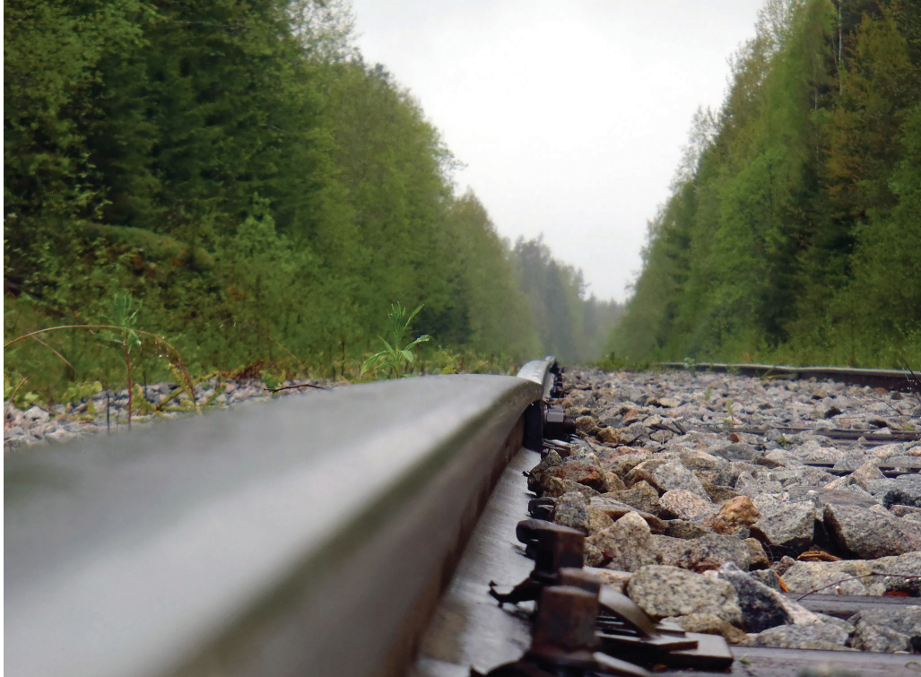
Kuva 53. Voimakkaasti painuneita kiskonjatkoksia Mynttilä–Ristiina-radalla. Kuva: Janne Sorsa
