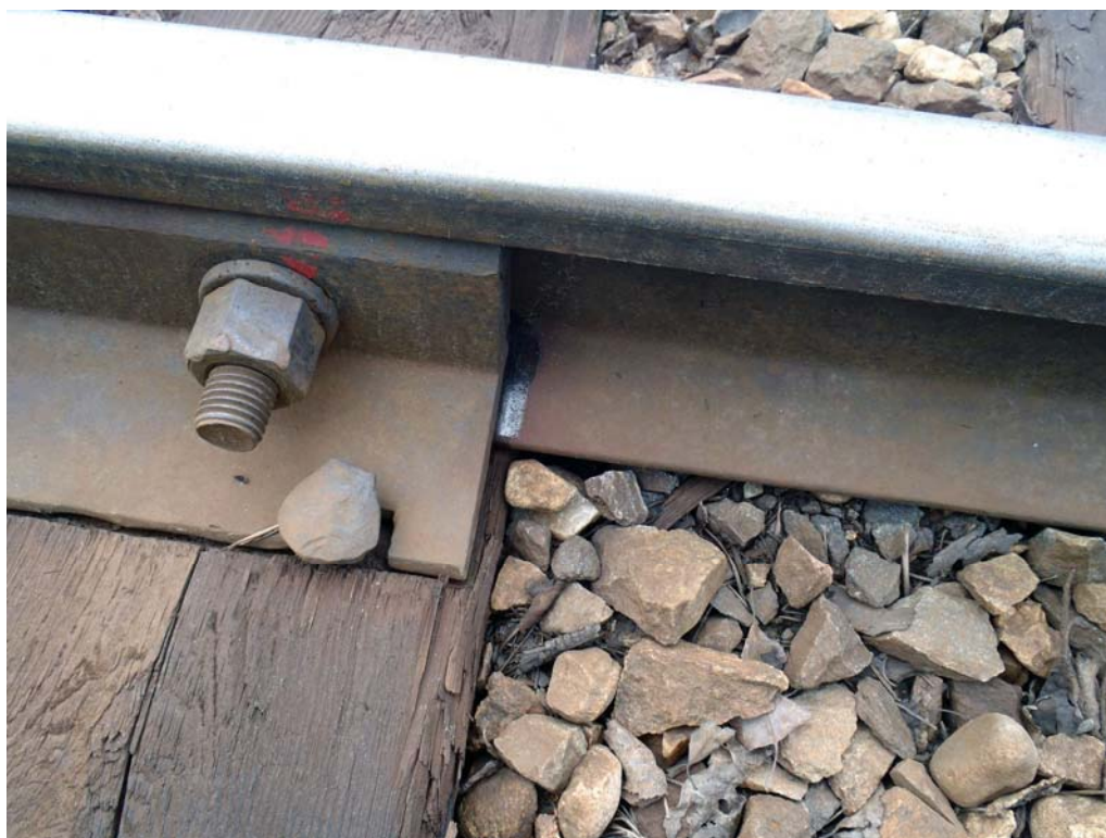
Kuva 82. Huollettu jatkos Ämmänsaaren radalla. Huollossa jatkos avataan ja vaihdetaan komponentteja tarpeellisilta osin. Samalla suoritetaan myös jatkoksen ja kiskon välin rasvaus. Toimenpide vaatii merkittävästi resursseja. Kuva: Janne Sorsa.
