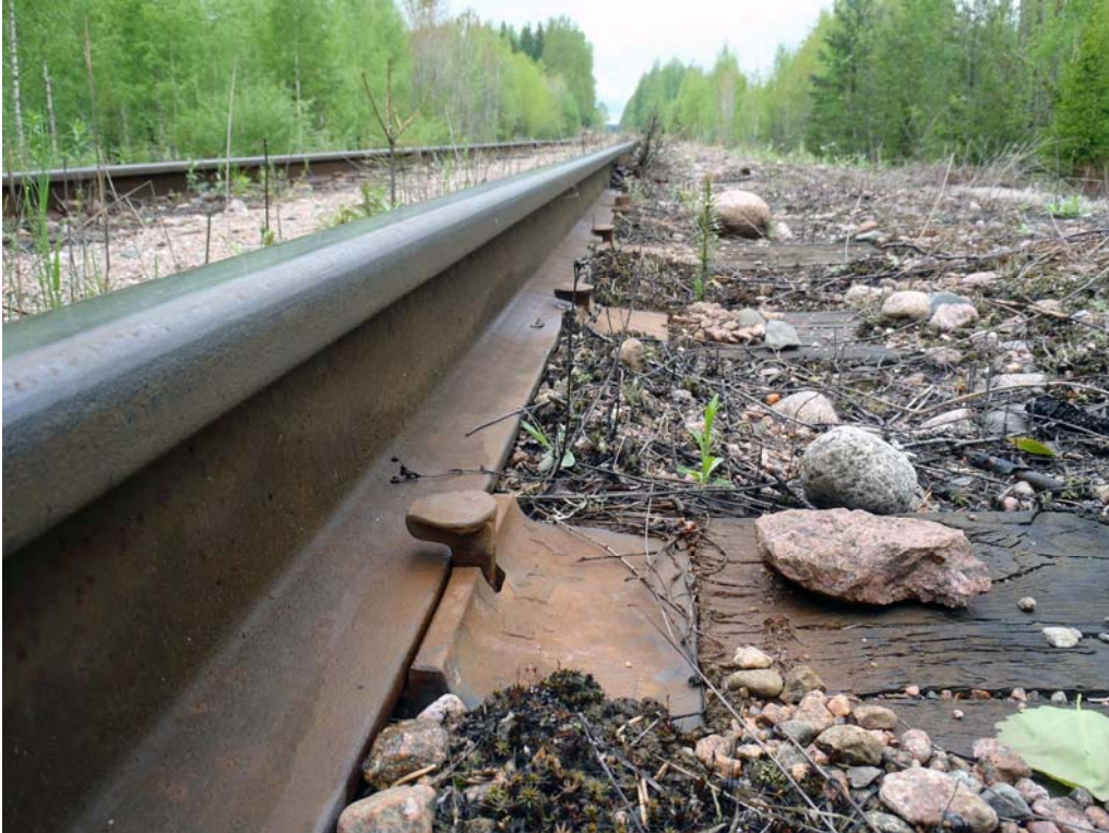
Kuva 9. Huonolaatuisessa soratukikerroksessa rata elää ja sen seurauksena naulakiinnitysten naulat nousevat irti kiskosta. Ajan ja pölkyn pehmenemisen myötä myös kiskon aluslevy painuu pölkyn sisään liikenteen vaikutuksesta. Naulauksen väljenemisen vuoksi naulan lyöminen uudelleen pohjaan on vain hyvin lyhytaikaisesti tilannetta parantava ratkaisu. Kuva: Janne Sorsa.
