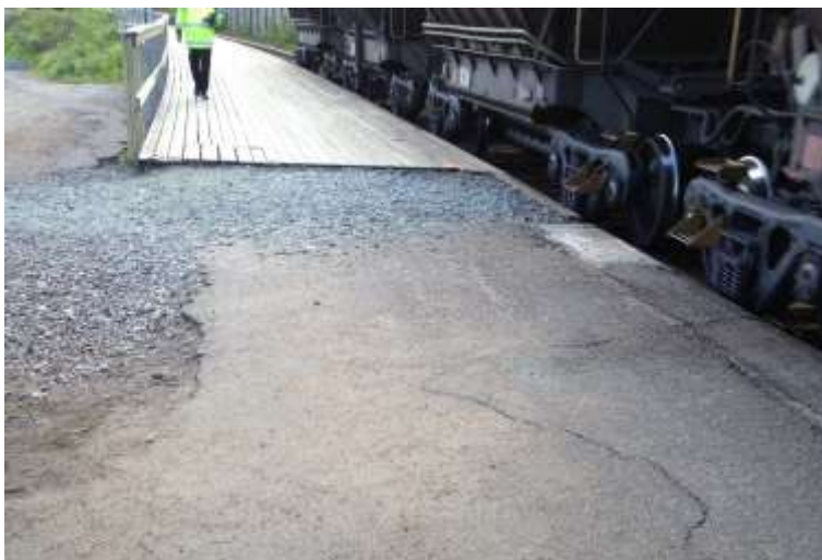
Sprickor och trasig asfalt på delar av plattformen.
