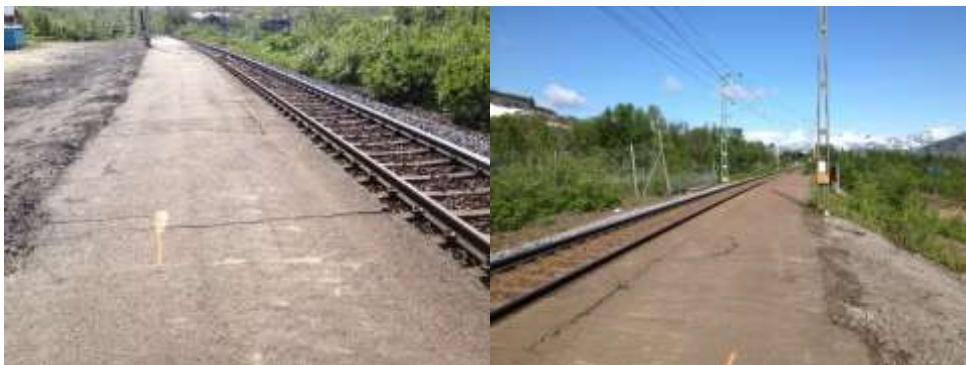
Plattform i dåligt skick och med få funktioner.
