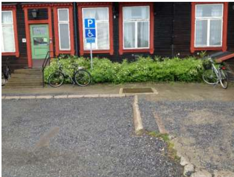
Parkering, anpassad för funktionshindrade, är i dåligt skick.
