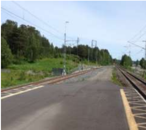
Bild 8.1 Avspärning saknas på plattformen i Notviken station, här finns istället en ramp.
