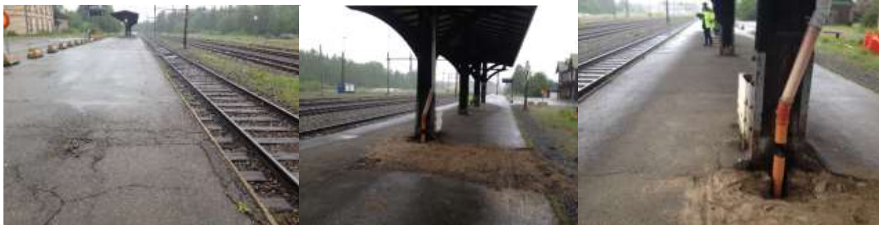
Sprickbildningar längs hela plattformen. Bortskuren asfalt under skärmtaket Hål i marken vid en av pelarna
