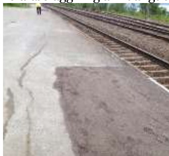
Skada på plattform1.
