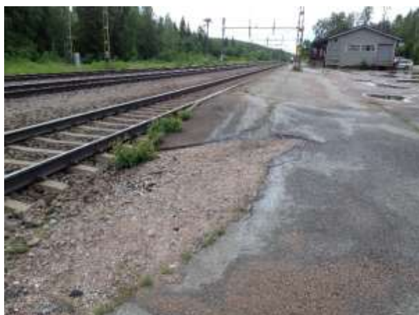
Plattformens markbeläggning är dålig.
