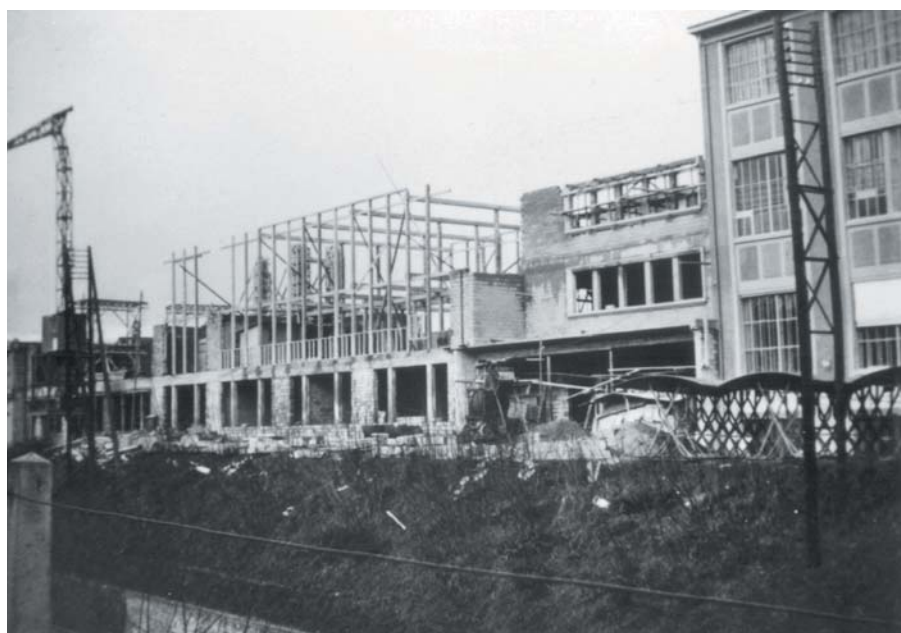
1943, construction du bâtiment des services techniques dans le prolongement du bâtiment Pic-Pic. L'ossature en béton est revêtue d'un bardage en ciment.
