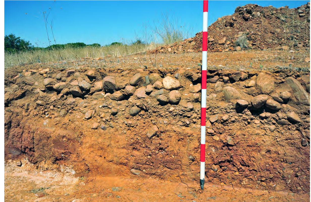
Detalle del firme de la vía romana. Sustrato arcilloso blando, regularización con zahorras naturales menudas, cimentación de gravas gruesas y capa de rodadura, casi desaparecida, de zahorras menudas de nuevo.
