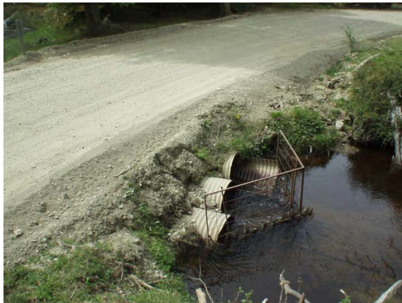
Reja para protección de alcantarilla en RN3 (Foto P. Kunzle)
