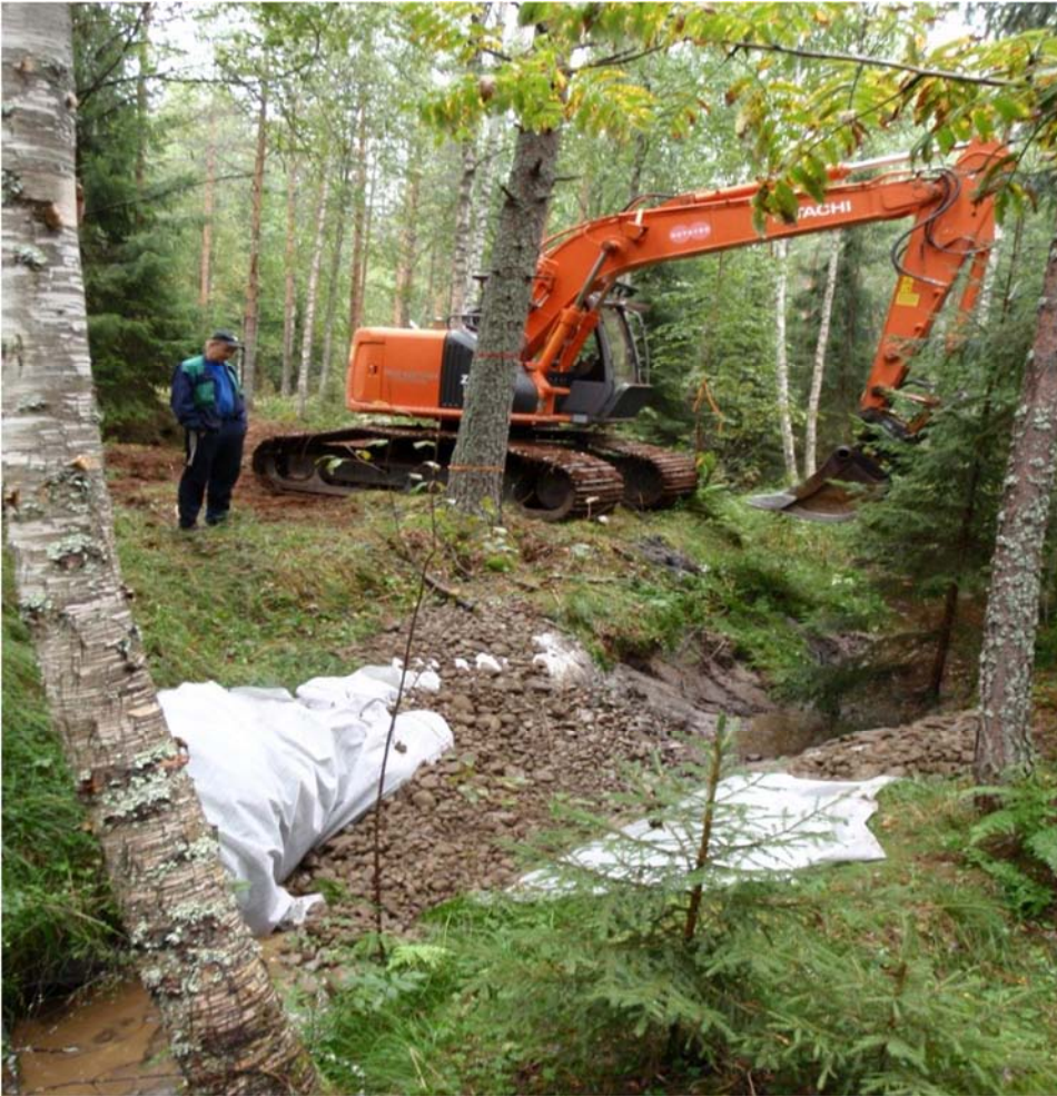
Kuva 7.1. Pohjapadon rakennusta pieneen metsäjojaan. Vesijohtoputki tulee laittaa padon pohjalle ennen kivien kasaamista, jolloin pato voidaan tarvittaessa tyhjentää. Kiveys on tärkeää nostaa korkealle reunapenkereille, ettei vesi kuluttaisi uutta reittiä padon ohi sen reunojen kautta. Pato säädetään matalimmaksi uoman keskikohdalle, jolloin suurin veden paine vaikuttaa padon keskelle patomateriaaliin ja eroosioherkät reunapenkat säästyvät (Raassina 2011).
