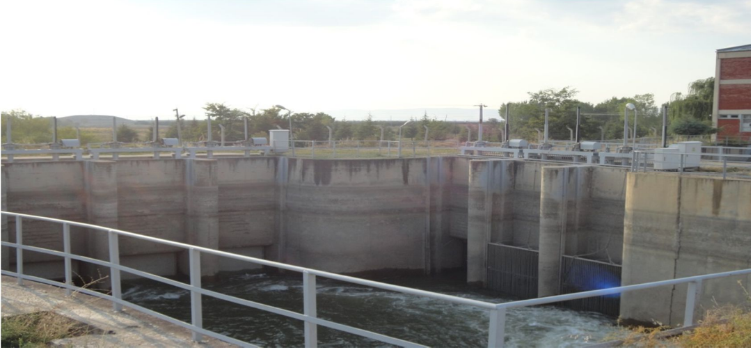
Şekil 35. Seraserli Barajı kapakları.
