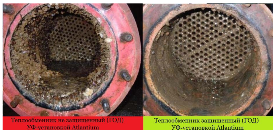
Рис. 2. Трубчатые теплообменники спустя 6 месяцев работы
