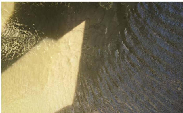
Рис. 13. Внешний вид дна БИГ энергоблока № 6 Нововоронежской АЭС
