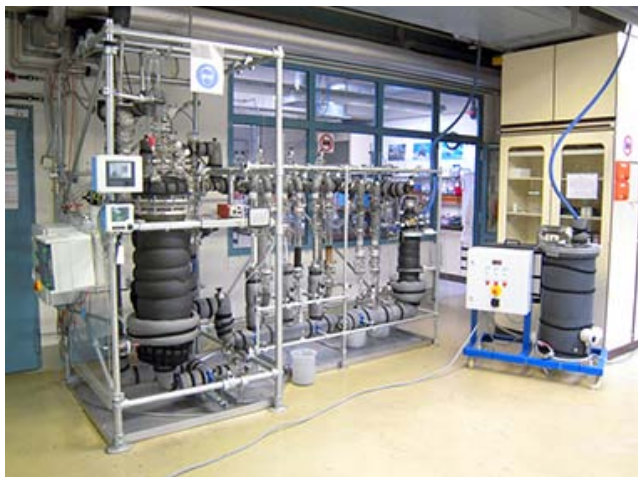
Рис. 3. Общий вид экспериментальной установки электрохимической дезактивации фирмы Siempelkamp
