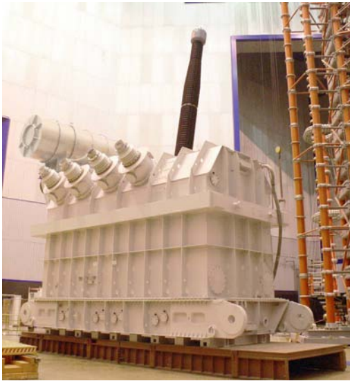
Рис. 4. Трансформатор ОРЦ-417000/750 в испытательном зале
