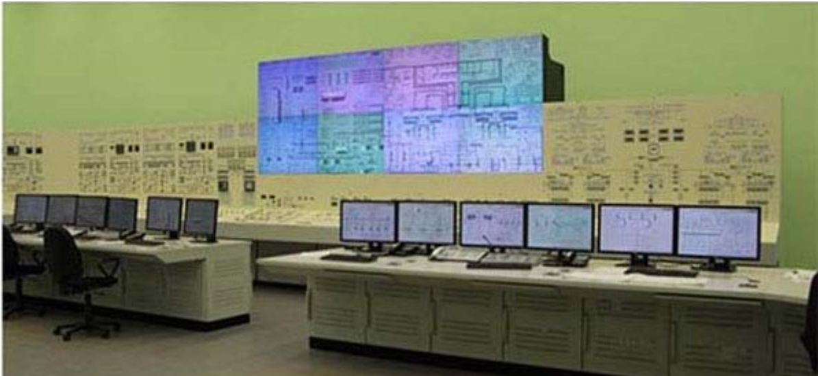
Рис. 11. Полномасштабный тренажер энергоблока ВВЭР-1200
