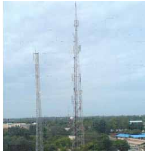
CDMA & GSM Antennas
