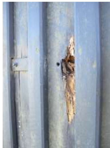
I en av dörrarna noterades en rötskada. Foto Hedvig Bellberg IMG 3533
