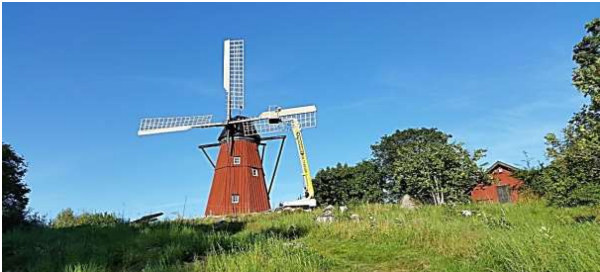
Vingarna monteras med hjälp av rep, så att de inte snurrar, och en skylift som når att fixera vingarna i vingaxeln. Här på kvällen den 21 augusti. Foto Per-Inge Gyllenhammar
