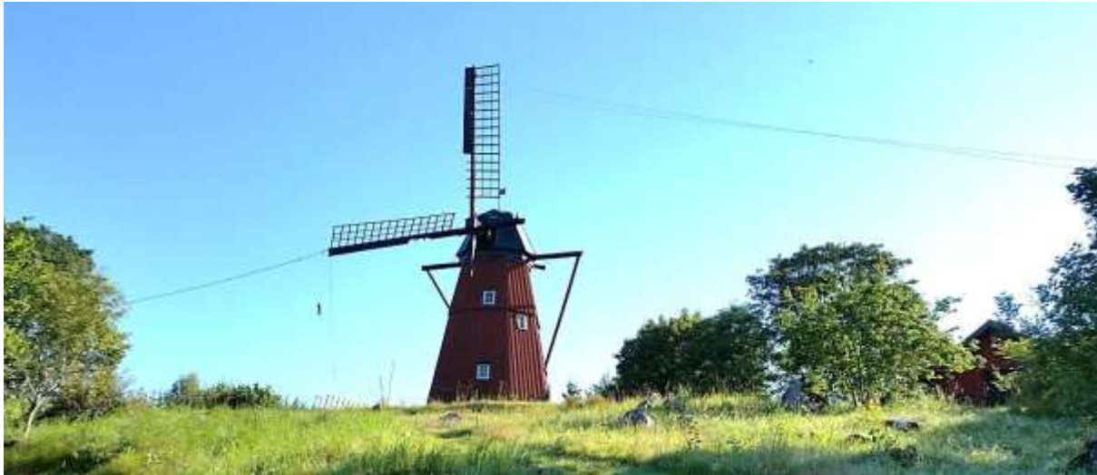
När de nya vingarna skulle monteras fixerades de gamla vingarna med rep, för att tjäna som motvikter när de nya vartefter uppsattes. Foto Per-Inge Gyllenhammar
