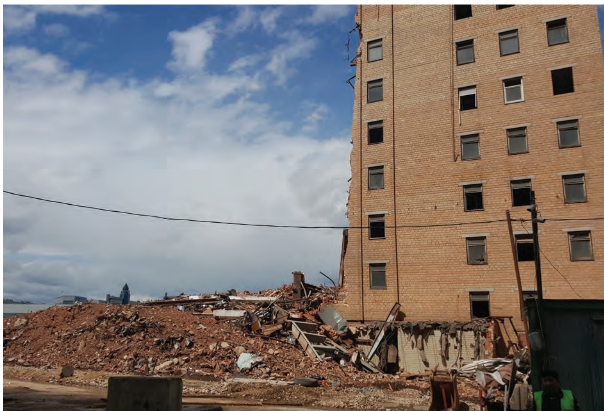
▲ Корпус «Кавказ» в стадии разрушения. Июнь 2018 г.
