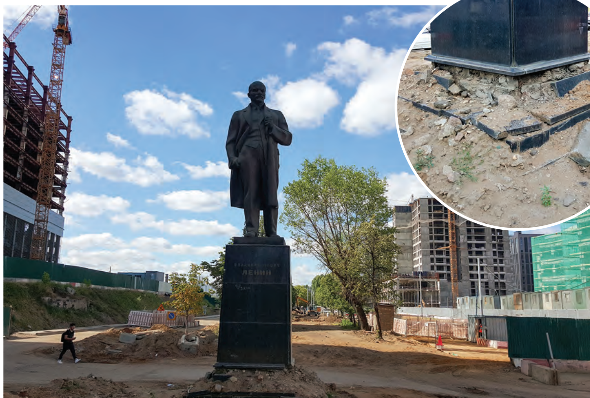
▲ «...От его постамента отваливаются плиты». Июнь 2018 г.
