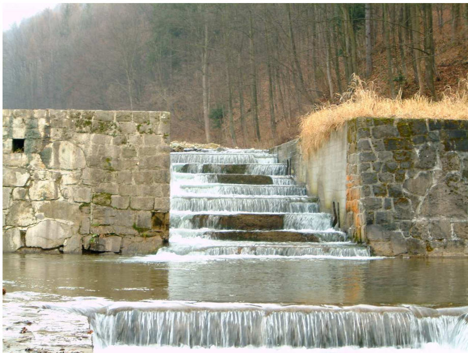
Fot. 11 Przepławka centralna na potoku Wierchomla (dorzecze Popradu), Jeden z proponowanych sposobów udrożnienia zapór – obiekty nr 105 i 107
