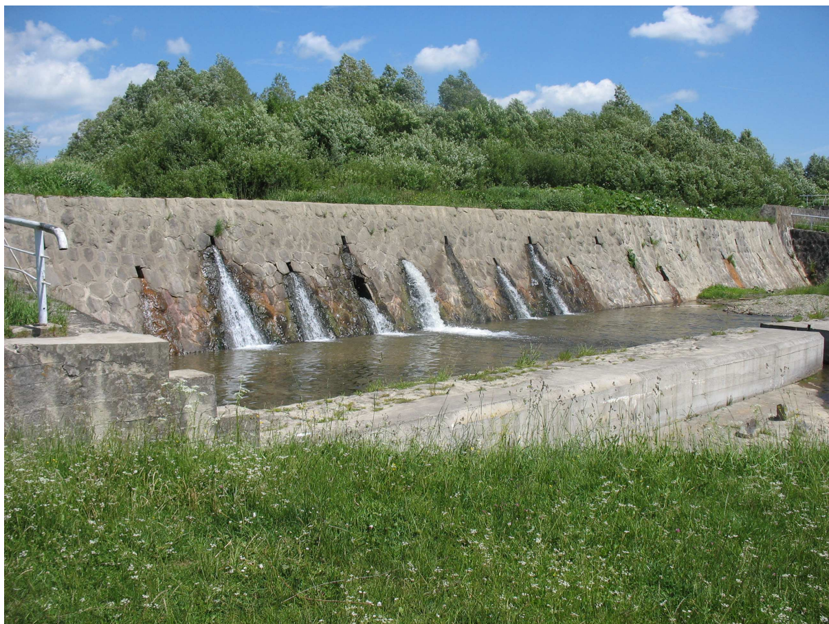
Fot. 12. Zapora przeciwrumowiskowa na potoku Lipnica
