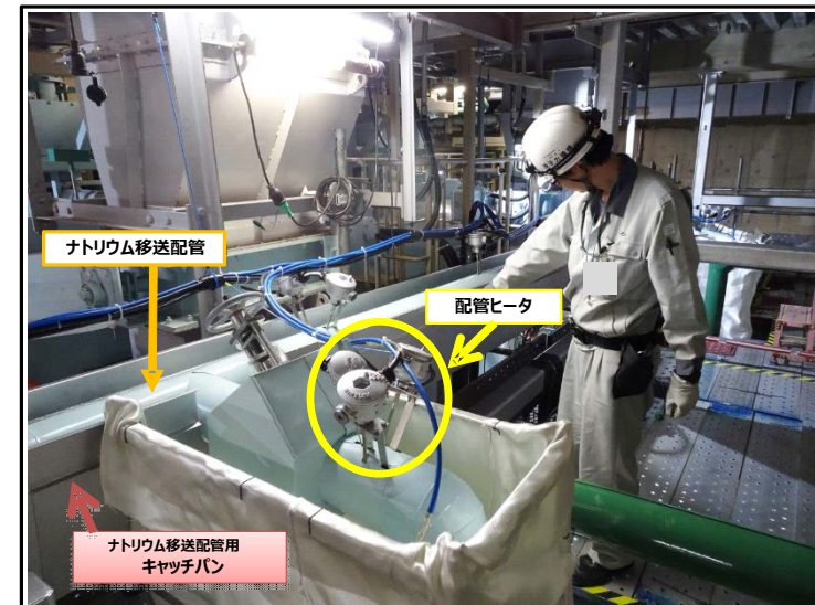
ナトリウム移送配管
