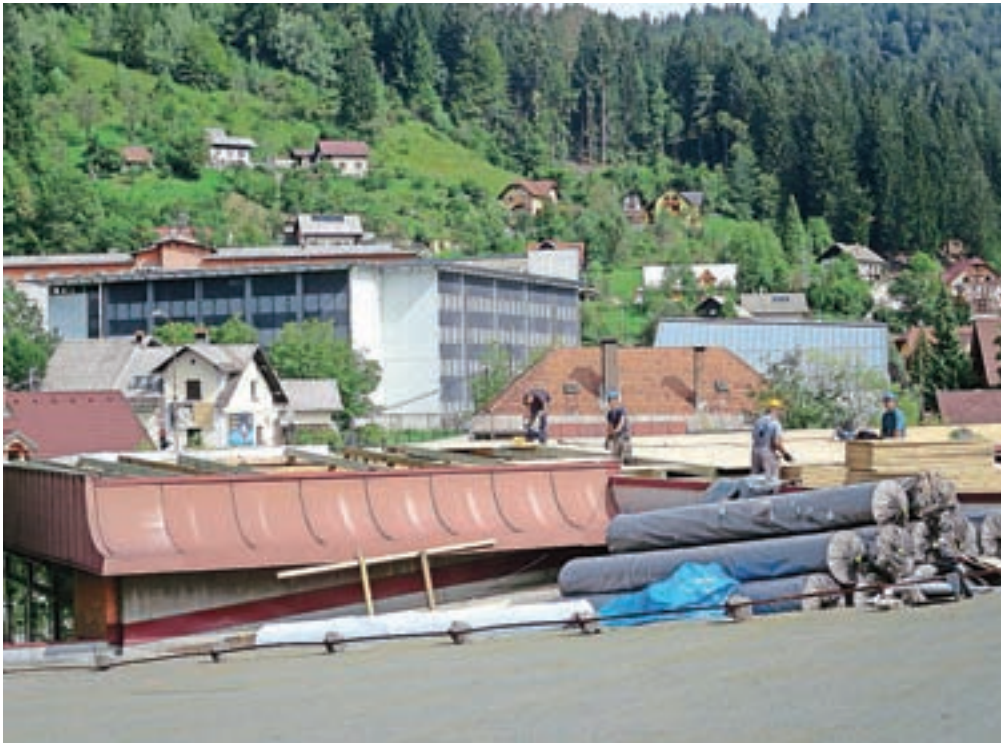
Obnova strehe na OŠ Toneta Čufarja ni potekala tako, kot bi morala. Zdaj bo dela opravil drug izvajalec.
