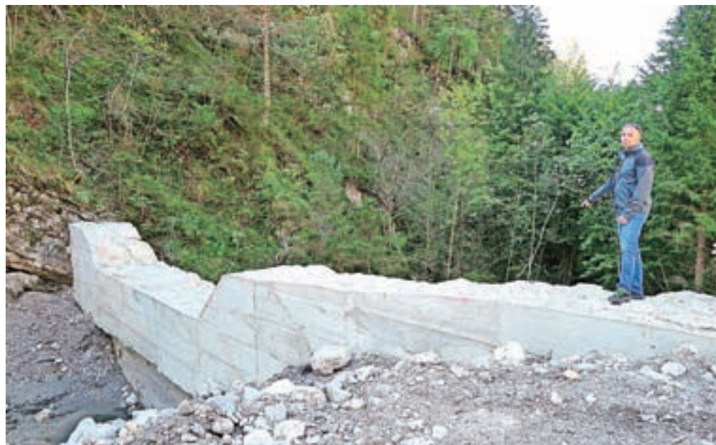
Prodne pregrade so namenjene zadrževanju materiala, ki ga hudournik prinese iz zalednih grap s planine. Pregrado pri vodohranu nad vasjo so že dvignili za en meter in s tem povečali zaplavni prostor za njo. Ko bo zgrajena cesta, bodo zgradili še dve novi pregradi.
