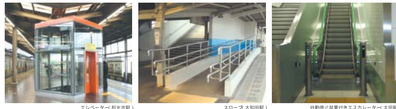
エレベーター(和光市駅)
