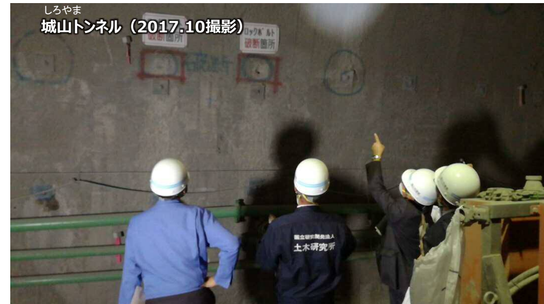
ロックボルト破断箇所(2017.7発生)の確認
