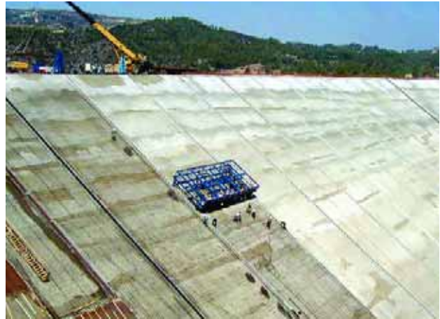
Σκυροδέτηση της ανάντι πλάκας του φράγματος Κανναβιούς με την τεχνική κυλιόμενου ξυλότυπου
