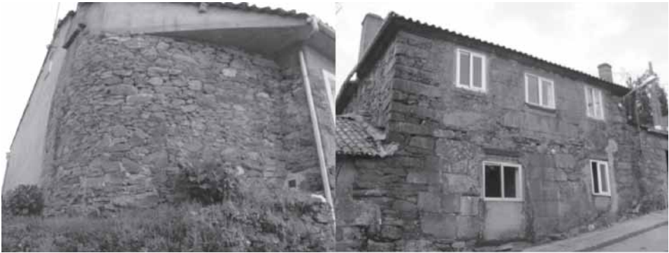
Actualmente intervénese sen medida nestas construcións populares, producindo, tal como denuncia esta imaxe, a súa degradación ante a indiferenza de quen debe sen evitalo. Mostra dunha intervención desastrosa nunha casa da aldea de Sabugüeira. Á esquerda, imaxe do lateral; á dereita, portas, ventás e teito.
