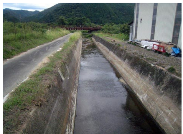
写真2 1年を経過した溪流 A ②付近。堆積した土砂の後が壁面に残っている。(2010. 9)
