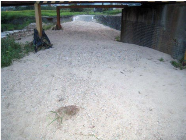
写真3 被災直後の溪流A③上流付近。河川から土砂があふれて道が堆積した。(2009. 8)
