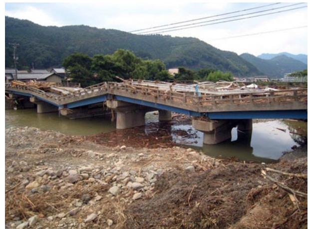
写真 14 災害直後の橋梁被災状況. (2009. 8)
