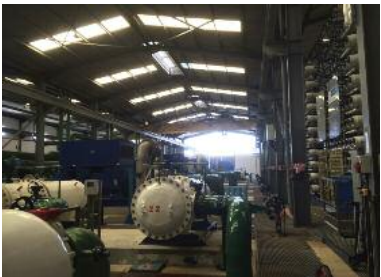
Μονάδα αφαλάτωσης Δεκέλειας.
