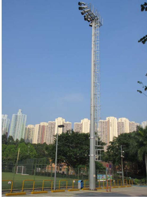
(7) 晒草灣堆填區的射燈裝置
