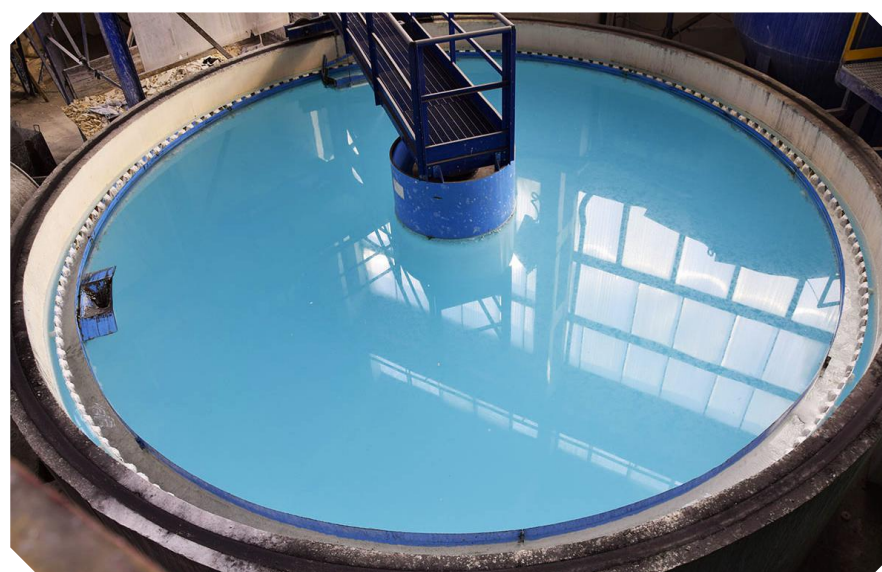
Энерго Алюминий - Бассейн для отделения гидроксида алюминия
