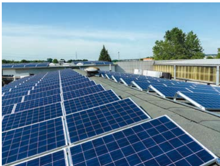
Für den Strom von der Photovoltaikanlage auf seinem Dach zahlt dieser metallverarbeitende Betrieb bei Frankfurt zusätzlich zu den Erzeugungskosten der PV-Anlage knapp sieben Cent EEG-Umlage pro Kilowattstunde um die Energiewende zu finanzieren. Seine großen Mitbewerber kaufen ihren klimaschädlichen Strom ohne sich an der Energiewende zu beteiligen. Foto: Sonneninitiative
