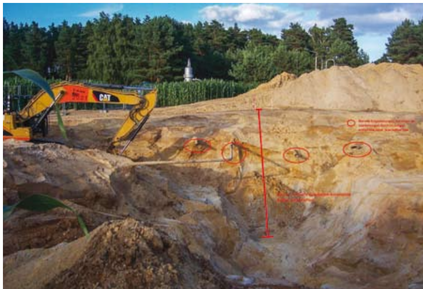
Große Leckage an Rohgasrohren bei Kakerbeck (Altmark) Foto: Bernd Ebeling
