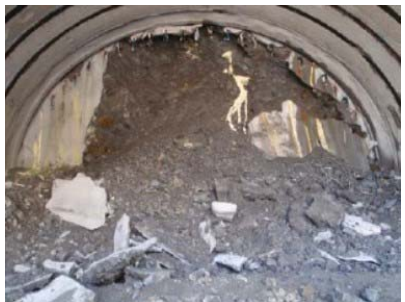
写真①: 鏡吹き付け後の崩落
