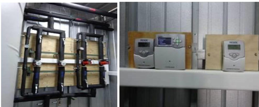
Figura 18: Sistema de bombas y sistema de control del SST
