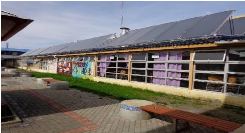
Figura 16: Colectores solares en los techos del Liceo Técnico Profesional Dr. Rigoberto Iglesias Bastías
