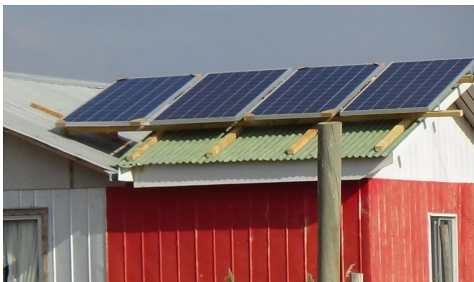
Figura 22: Paneles solares instalados en vivienda
