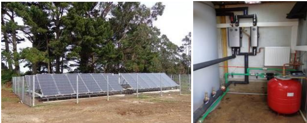
Figura 19: Colectores térmicos y sala técnica del internado del Liceo Rural Santa Rosa
