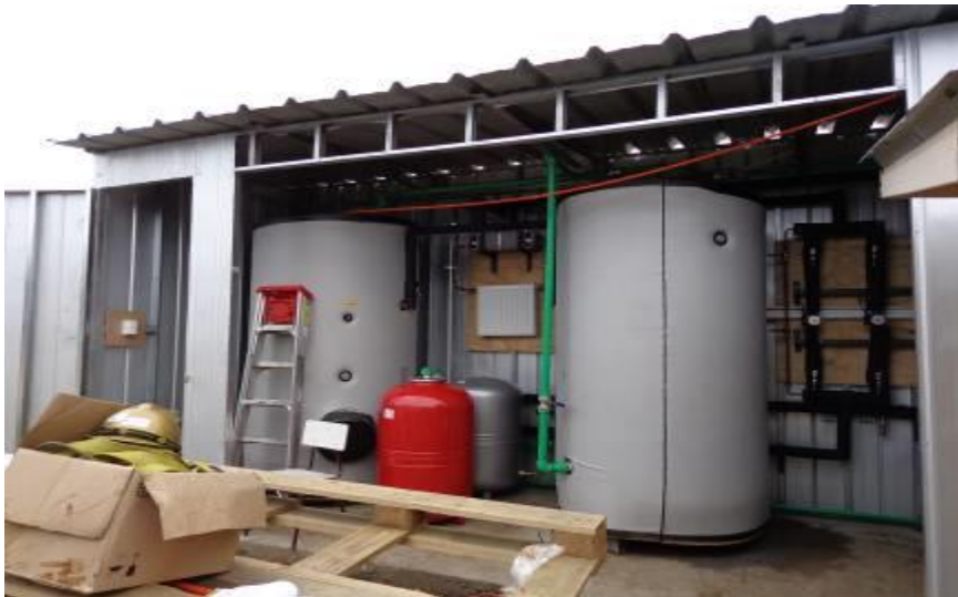
Figura 17: Sala técnica con almacenamiento de agua caliente para el internado
