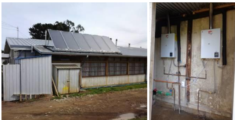
Figura 20: Colectores solares y sistema de apoyo del Liceo Rural Santa Rosa
