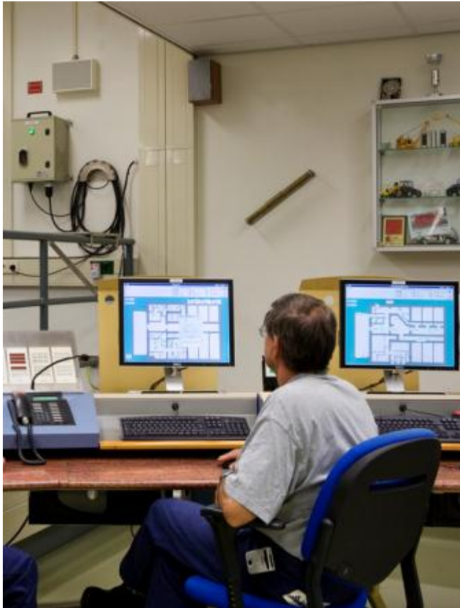
Figuur 8.13 : Controlekamer van het HABOG
