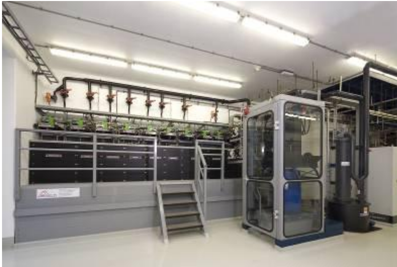
Figuur 6.5: Chemicaliën doseerstation
