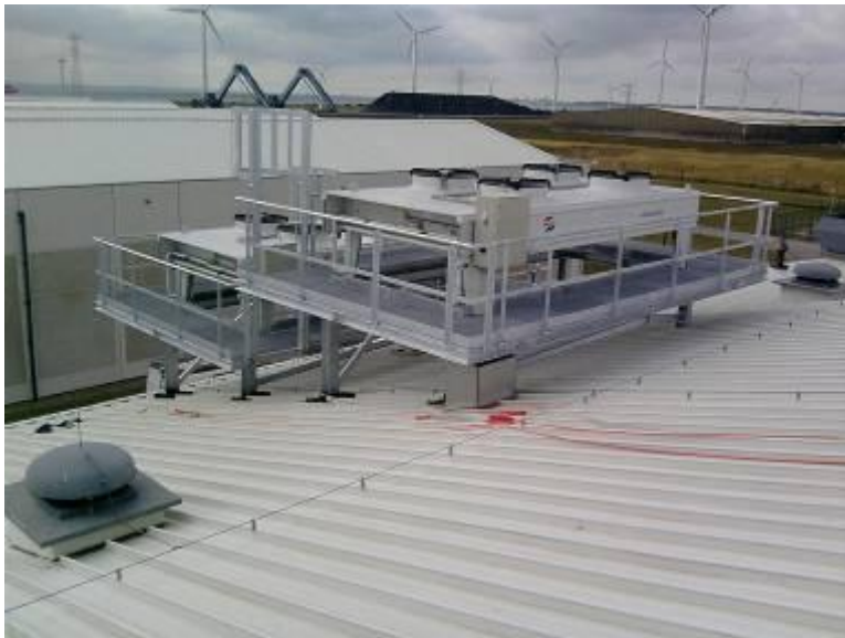
Figuur 6.19: Condensors van de koelmachines
