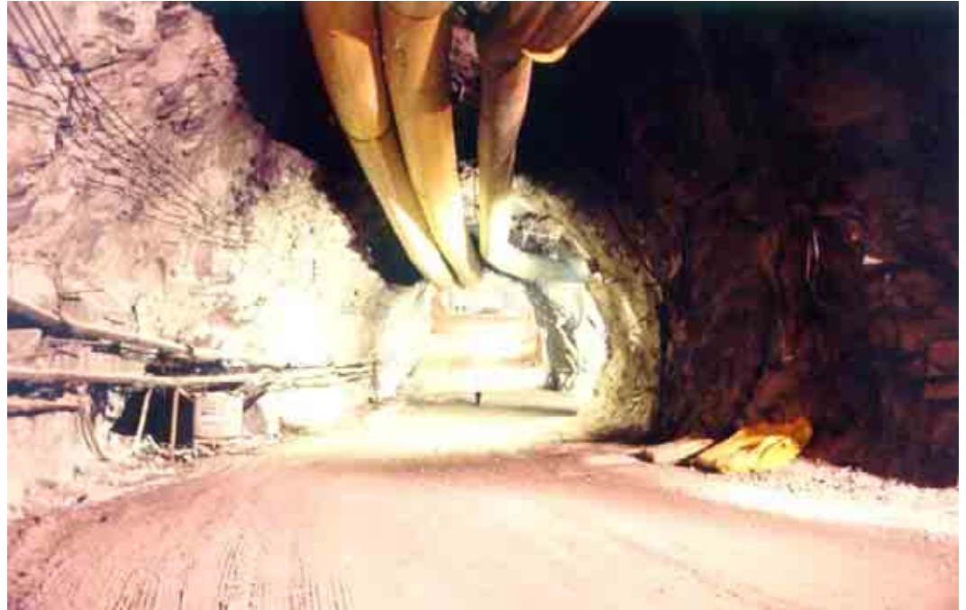
Figura 7. Túnel de acceso a casa de máquinas muy similar al planteado en el PH La Yesca.
