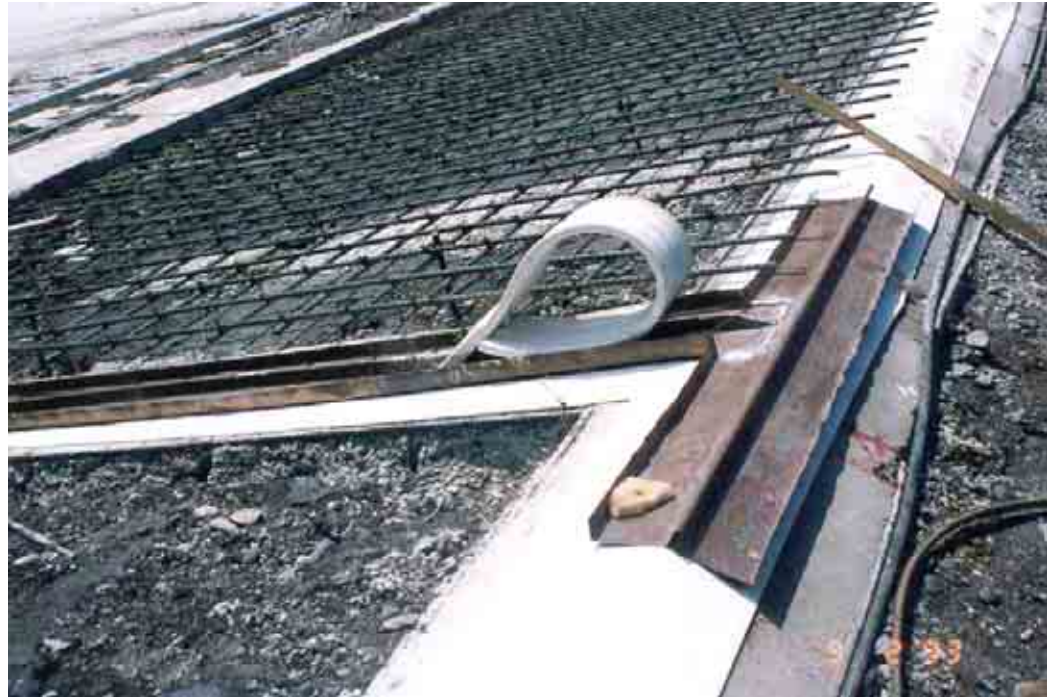
Figura 70. Junta tipo 10 en la cara de concreto. Se aprecia el dispositivo de unión del cobre y PVC.
