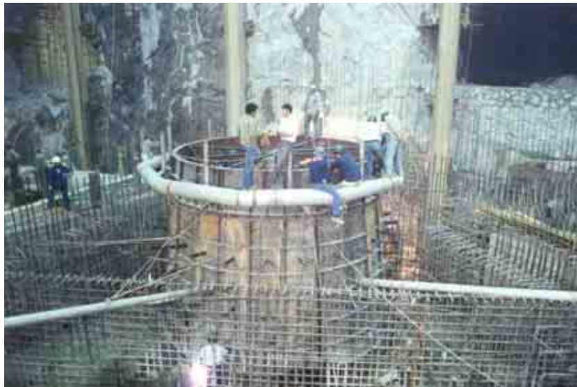
Figura 81. Vista de los conos superior e inferior del tubo de aspiración.
