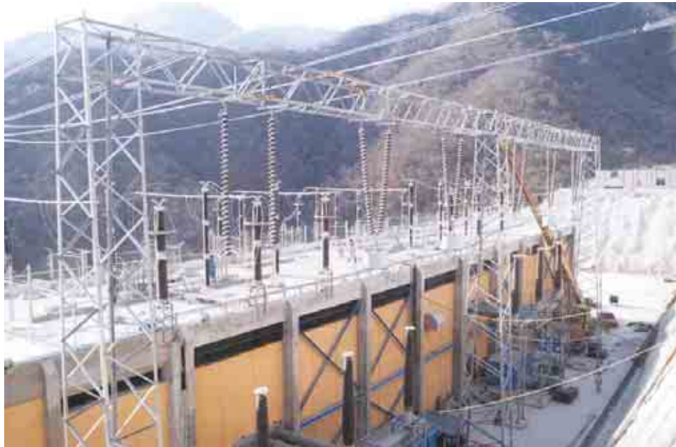
Figura 90. Disposición de los equipos exteriores de la subestación de 400 kV en SF6.
