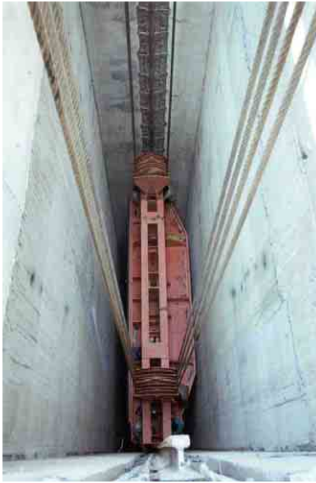
Figura 72. Deslizamiento de la compuerta de cierre final.
