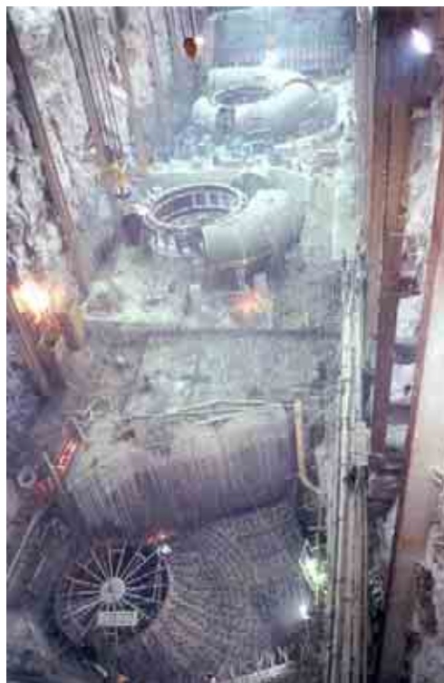
Figura 83. Vista general de casa de máquinas, obsérvese el tubo de aspiración en una unidad.
