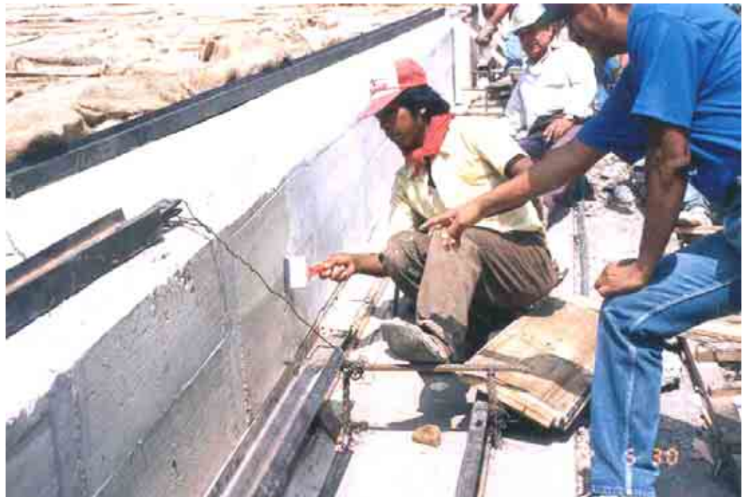
Figura 68. Junta vertical tipo 3 central en la cara de concreto de la cortina. Nótese la plantilla para el asiento de los sellos de cobre y PVC.
