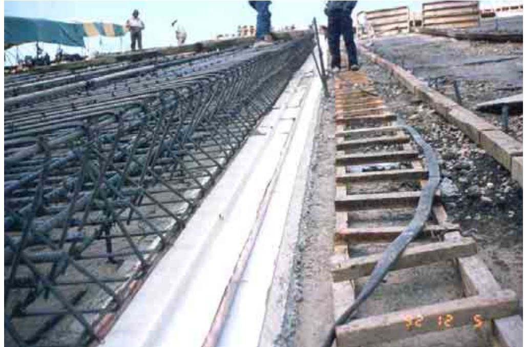
Figura 69. Junta vertical tipo 4 lateral de la cara de concreto de la cortina. Nótese la protección con PVC moldeados al sello de cobre para proteger la junta durante el tráfico de armados y cimbrado de la losa adyacente.
