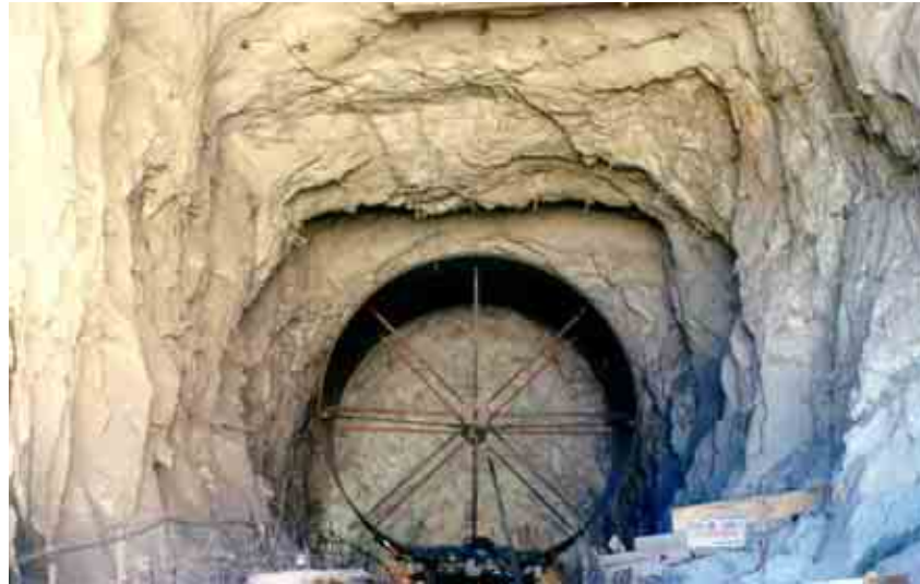
Figura 38. Proceso de lanzamiento de tubos para conformar el blindaje de las tuberías a presión.
