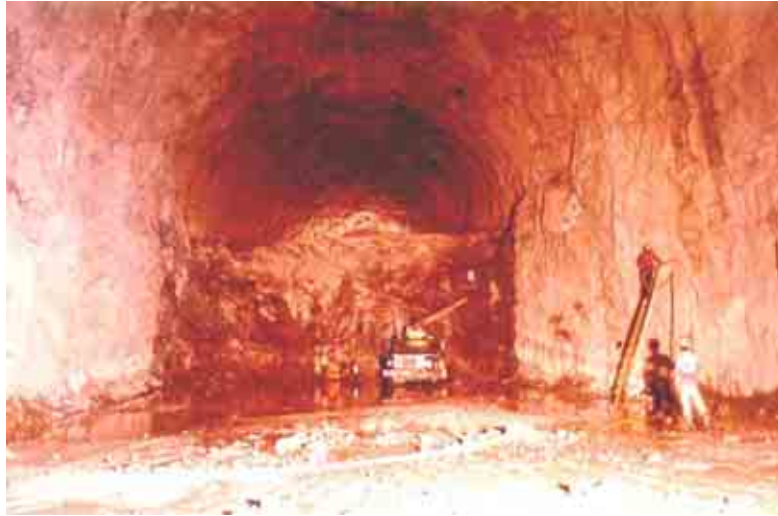
Figura 45. Inyección de anclaje en muros y carga de explosivos en banqueos del túnel de desfogue.
