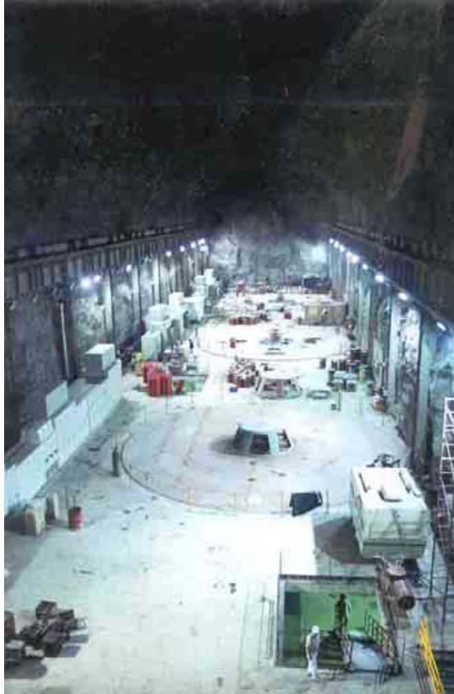
Figura 87. Vista panorámica de casa de máquinas donde se muestran las posiciones de los generadores de potencia.
