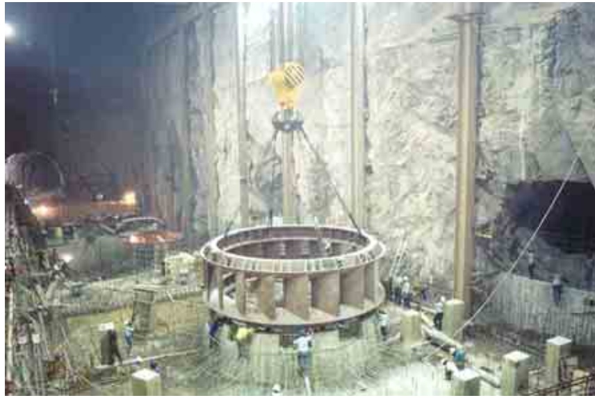
Figura 82. Montaje del antedistribuidor en su sitio en una de las unidades de casa de máquinas.
