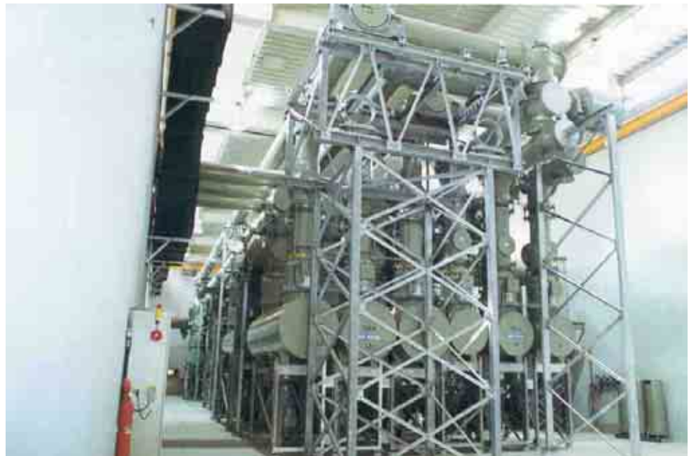
Figura 89. Subestación de 400 kV en SF6, una vez concluido el montaje.
