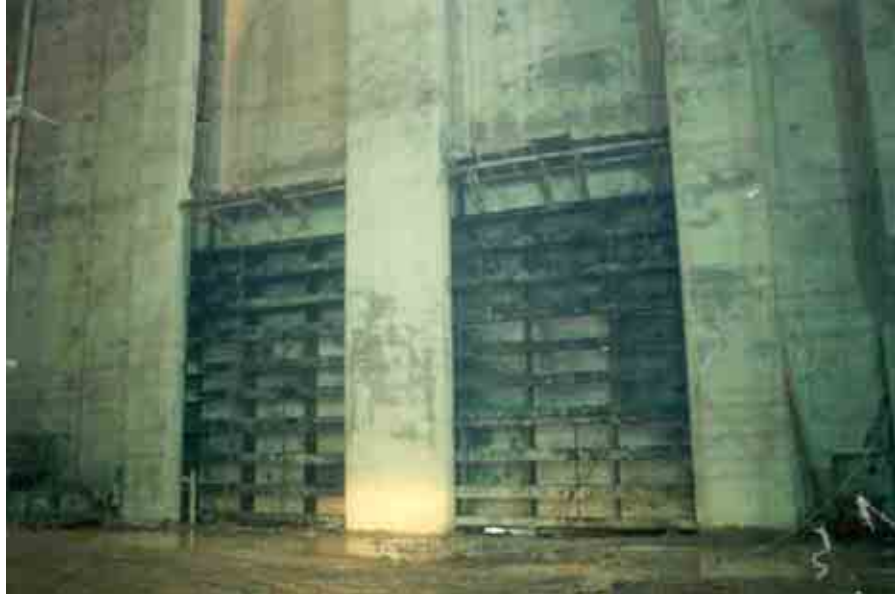
Figura 78. Compuertas en galería de oscilación.
