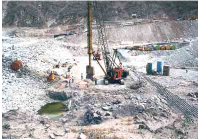
Figura 54. Construcción de la pantalla flexoimpermeable en la ataguía de aguas abajo con grúa y almeja guiada.
