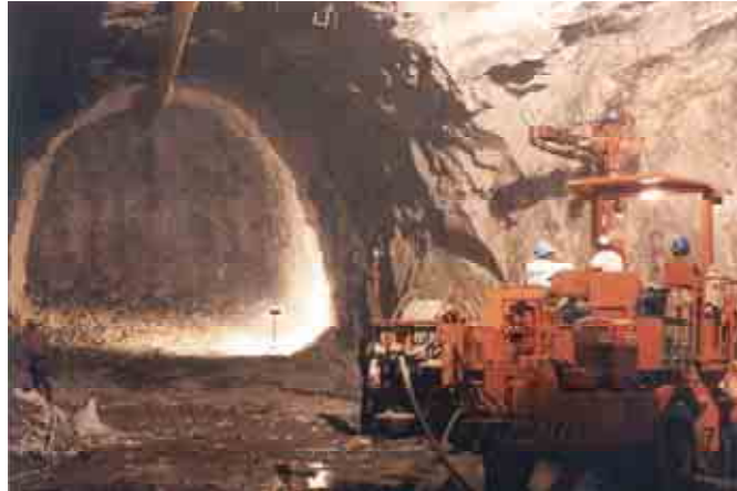
Figura 17. Barrenación para anclaje en las paredes de la caverna. Al fondo se nota el túnel auxiliar al tímpano de la casa de máquinas, procedimiento similar al PH La Yesca.
