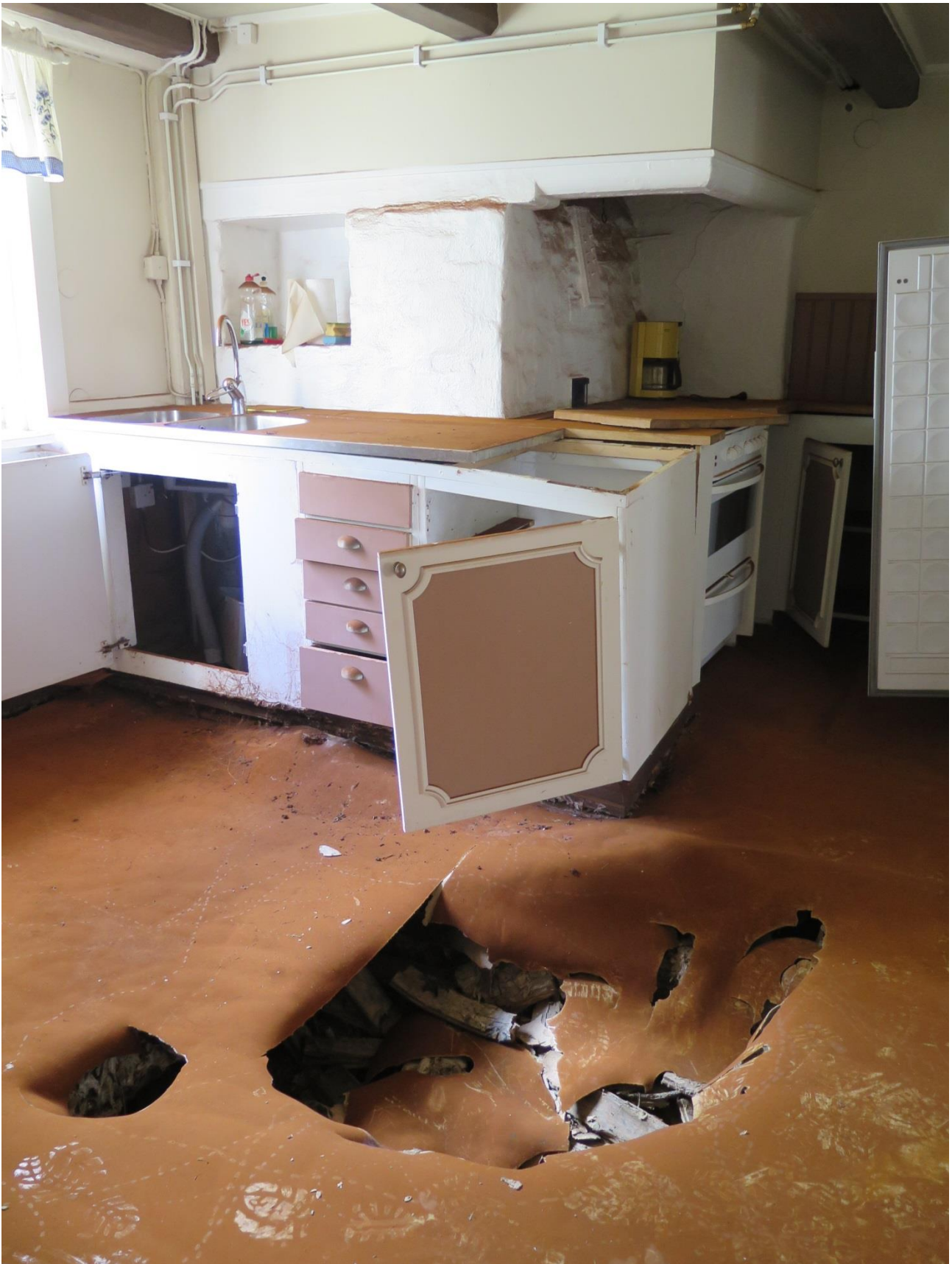
En upptäckt vattenläcka i köket skapade röta i golvet som gett vika. Köksbänkar och skåp är tillkomna runt 1950. Den äldre murstocken är synlig liksom nederdelen av ursprunglig spiskåpa. Överdelen har byggts in.
