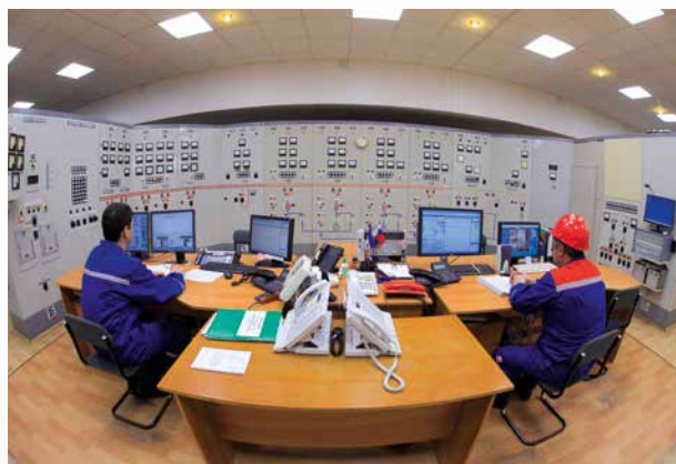
Главный щит управления
