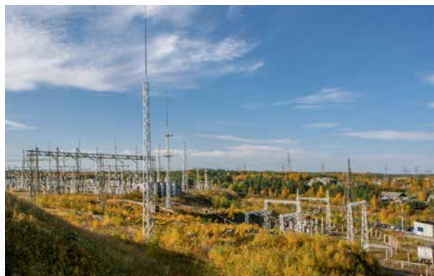
Открытые распределительные устройства 110 и 220 кВ
