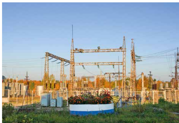
Распределительное устройство 110 кВ
