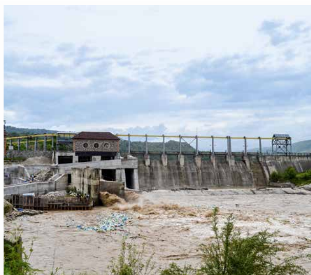
Резервный головной узел
