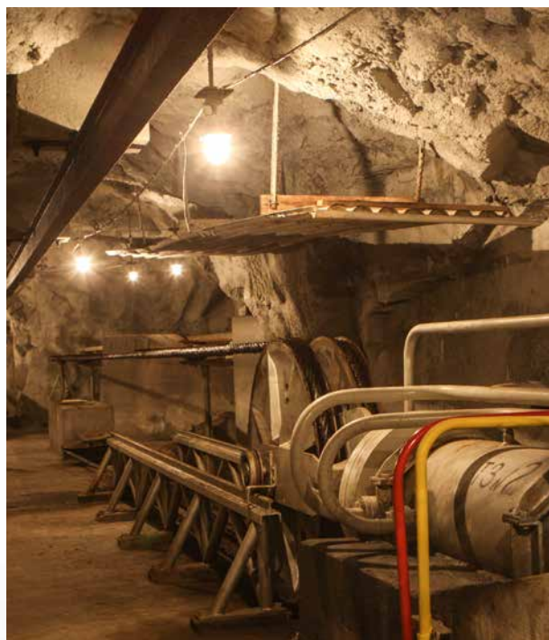
Подземный комплекс ГЭС
