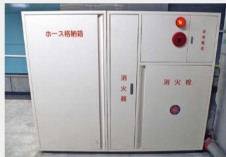
火災対策設備(屋内消火栓格納箱)
