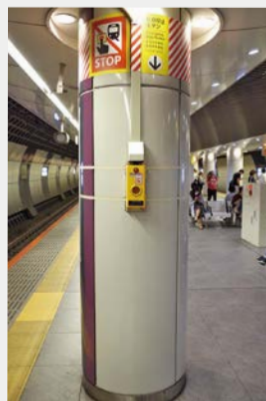
非常停止ボタン
