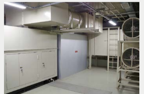
非常用発電設備
