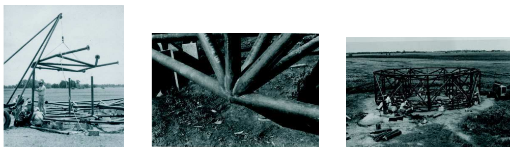
Figura 9 Izquierda: Comienzo de la construcción del anillo de acero central. Centro: Vista de uno de los nodos. Derecha: El anillo central terminado.
