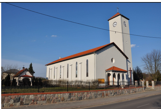
Remont Kościoła p.w. Św. Wawrzyńca w Sapolnie polegający na remoncie elewacji, zmianie konstrukcji i wymianie pokrycia dachowego wieży kościoła, portyku i absydy
