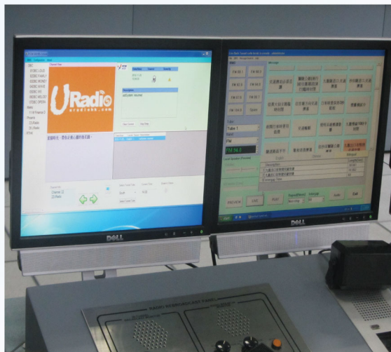
數碼聲音廣播系統控制台顯示各條數碼聲音廣播頻道的情况，並可在發生緊急情況時插播話音信息。 The DAB control console shows an overview of the DAB channels and allows for emergency voice break-in messages.
